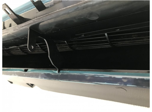
16.エアコンクリーニング
