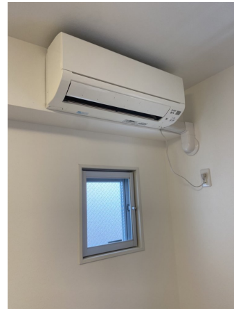
17.エアコンクリーニング
