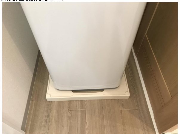
8.洗濯機防水パン
