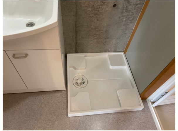
6.洗濯機防水パン
