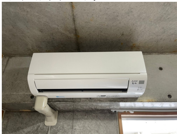
14.エアコンクリーニング
