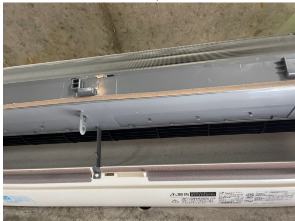
14.エアコンクリーニング
