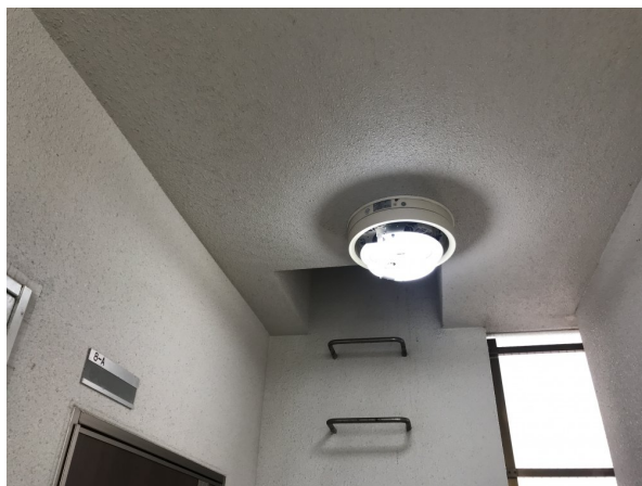
8-A 玄関前照明 20W丸・スターター交換
