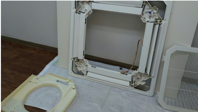
9.エアコンクリーニング
