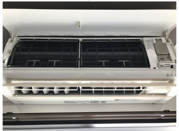
9.エアコンクリーニング
