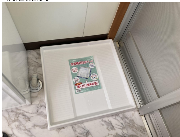
6.洗濯機防水パン
