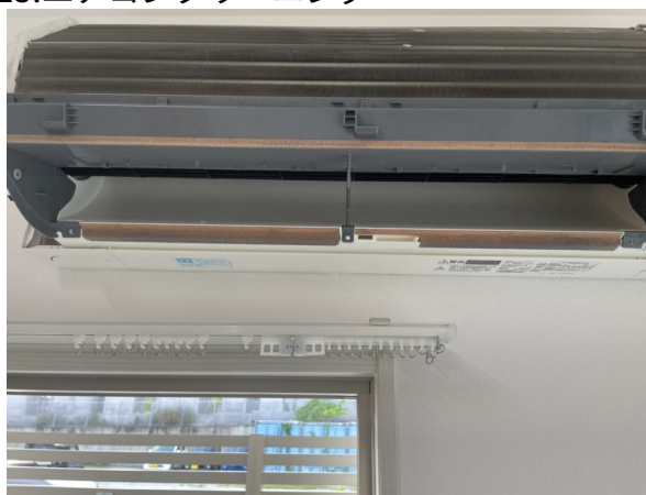
15.エアコンクリーニング
