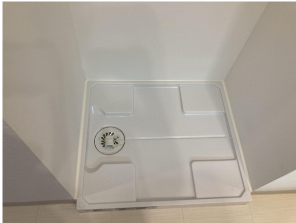
7.洗濯機防水パン
