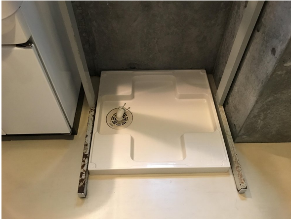
6.洗濯機防水パン
