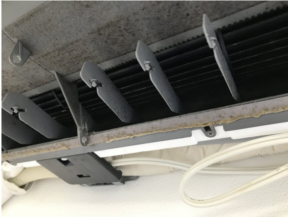
14.エアコンクリーニング
