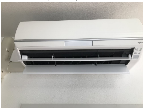
14.エアコンクリーニング
