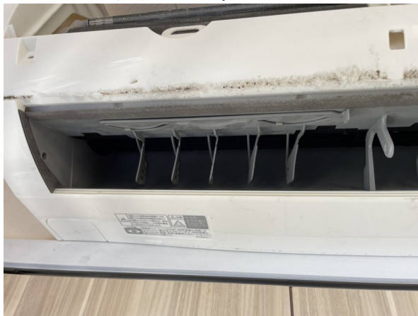
14.エアコンクリーニング
