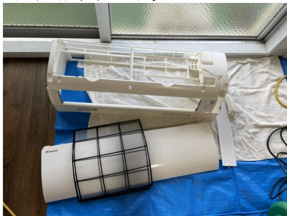
14.エアコンクリーニング
