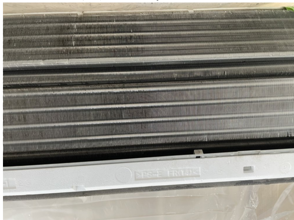
14.エアコンクリーニング
