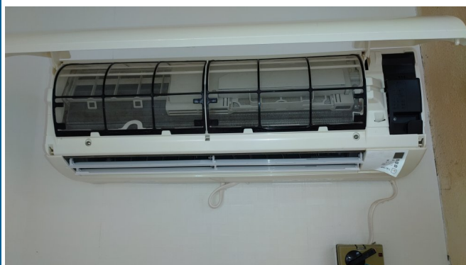
11.エアコンクリーニング
