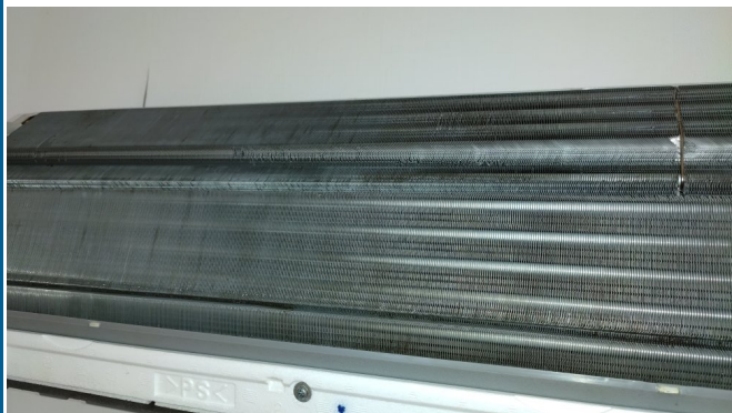
11.エアコンクリーニング
