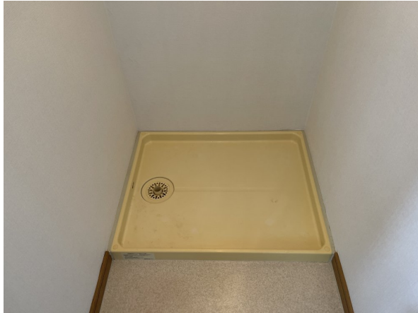
5.洗濯機防水パン
