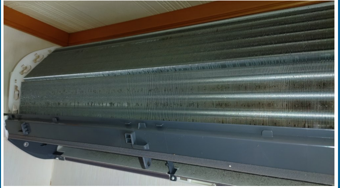
12.エアコンクリーニング
