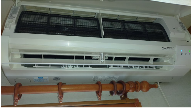
12.エアコンクリーニング
