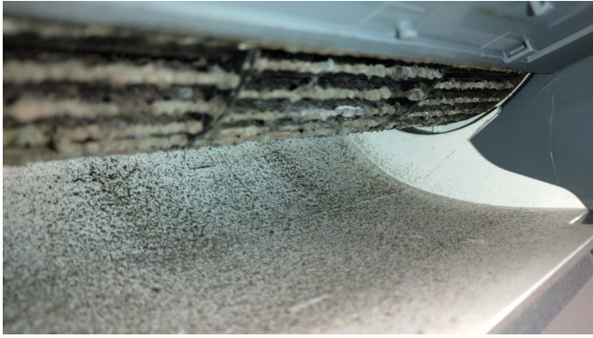
12.エアコンクリーニング
