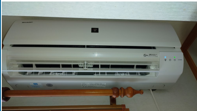
12.エアコンクリーニング
