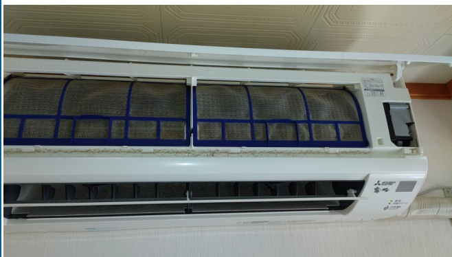
12.エアコンクリーニング
