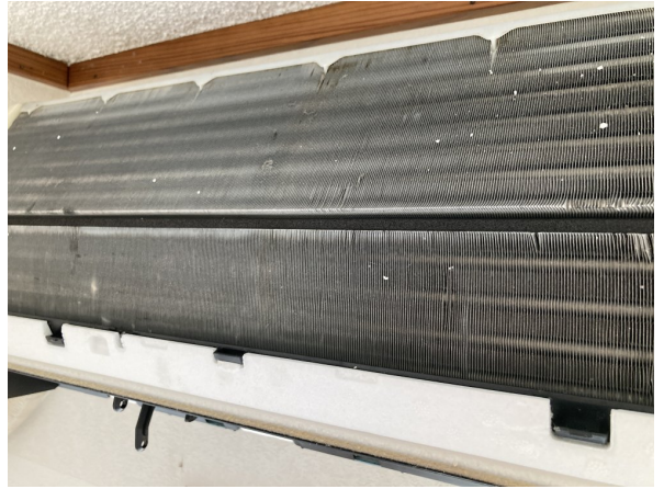
14.エアコンクリーニング
