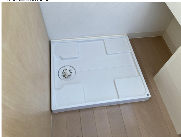
7.洗濯機防水パン
