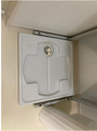
7.洗濯機防水パン
