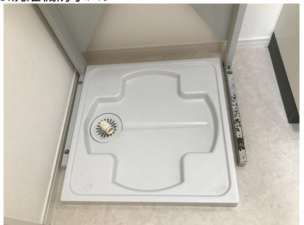
8.洗濯機防水パン
