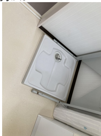
8.洗濯機防水パン
