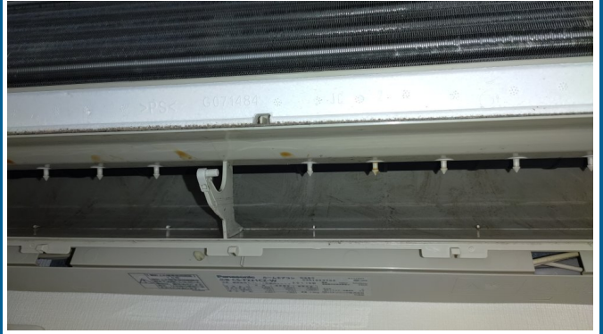
17.エアコンクリーニング
