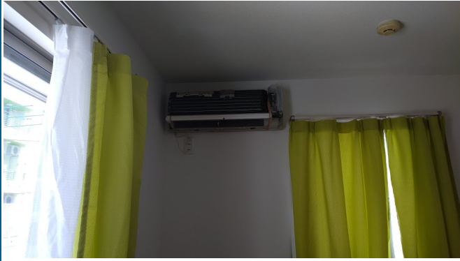
17.エアコンクリーニング
