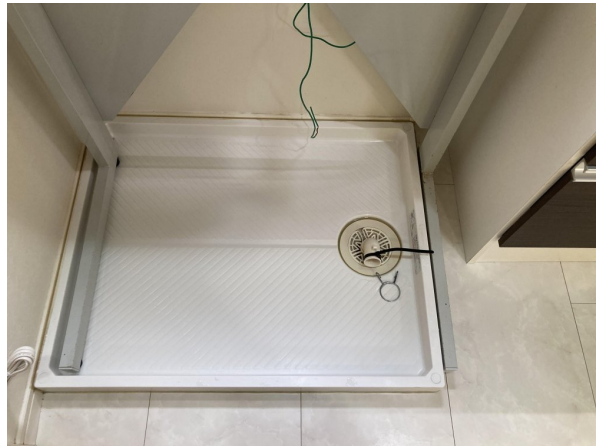
8.洗濯機防水パン
