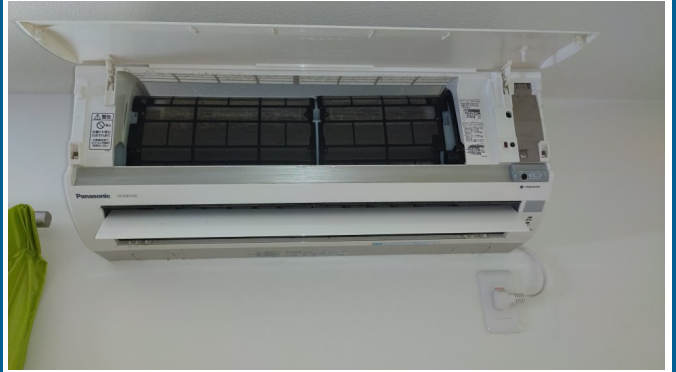
17.エアコンクリーニング
