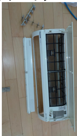
17.エアコンクリーニング
