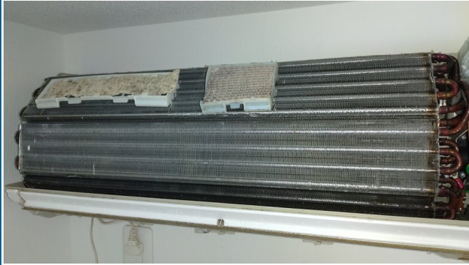
17.エアコンクリーニング
