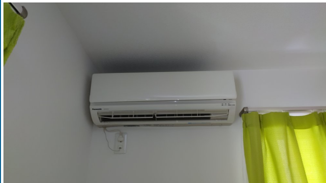
17.エアコンクリーニング
