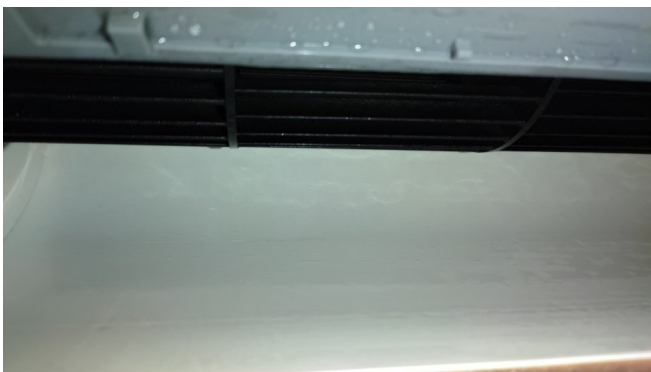
13.エアコンクリーニング
