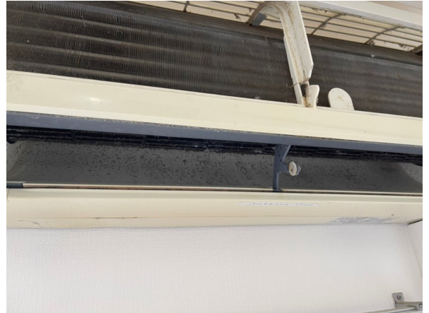
13.エアコンクリーニング
