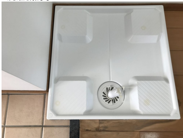
5.洗濯機防水パン
