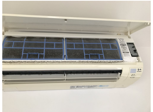
13.エアコンクリーニング
