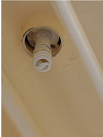
301号・202号室玄関前 電球切れ
