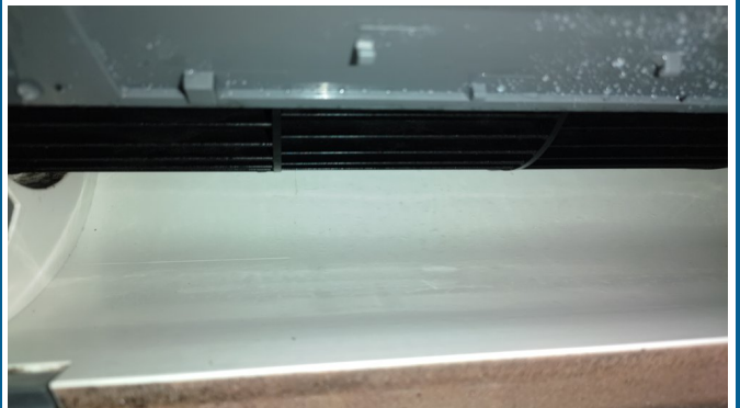
12.エアコンクリーニング
