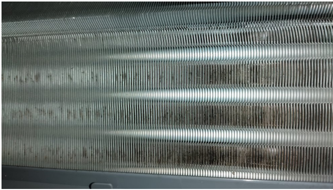
12.エアコンクリーニング
