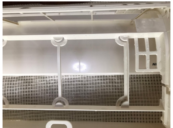
11.エアコンクリーニング
