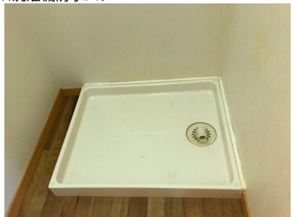
7.洗濯機防水パン
