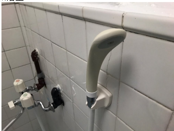
混合栓水漏れ。
