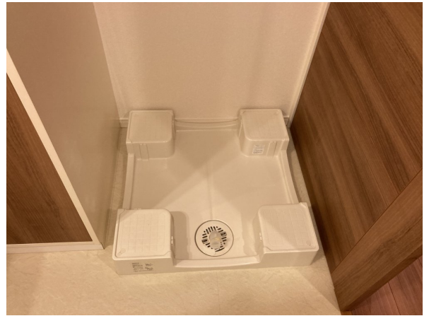
7.洗濯機防水パン
