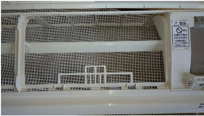
17.エアコンクリーニング
