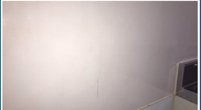
キッチン横 ひび割れあります
