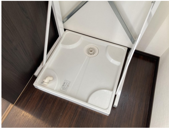
7.洗濯機防水パン
