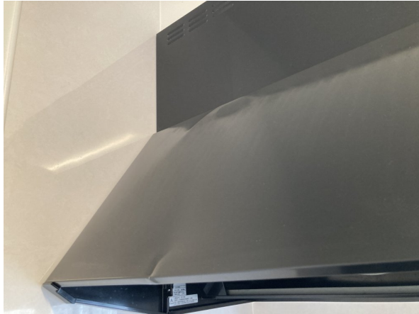
レンジフード、変形してます
