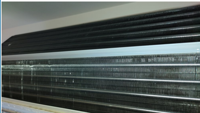
15.エアコンクリーニング
