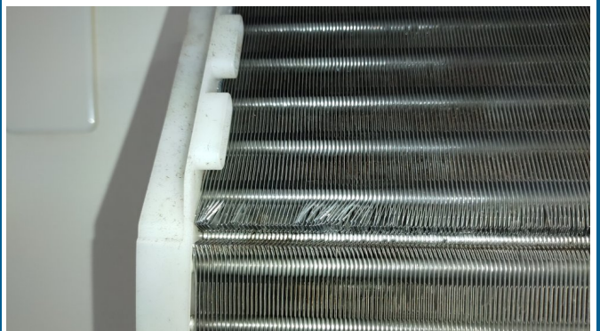
14.エアコンクリーニング
