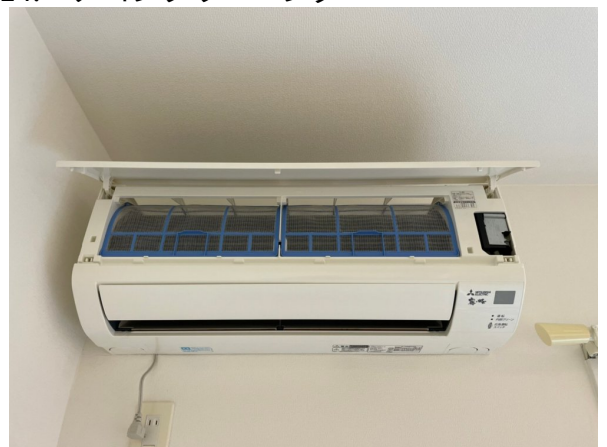
14.エアコンクリーニング
