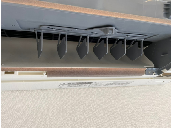
14.エアコンクリーニング
