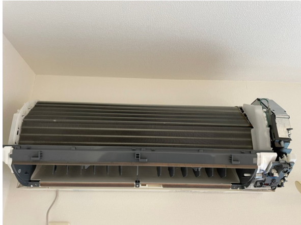
14.エアコンクリーニング
