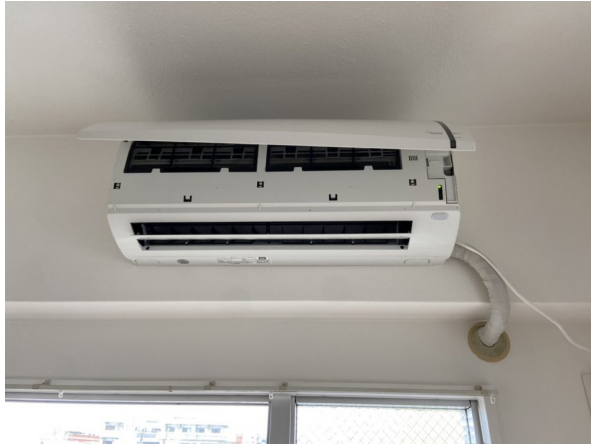
16.エアコンクリーニング
