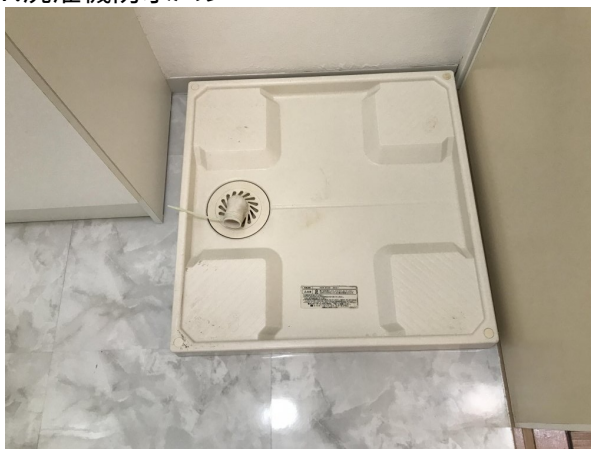
7.洗濯機防水パン
