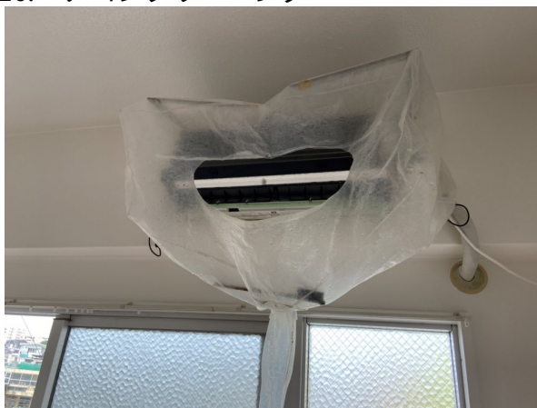
16.エアコンクリーニング
