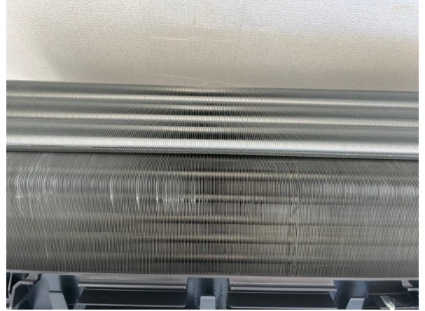
1.エアコンクリーニング
