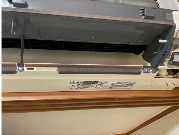
17.エアコンクリーニング
