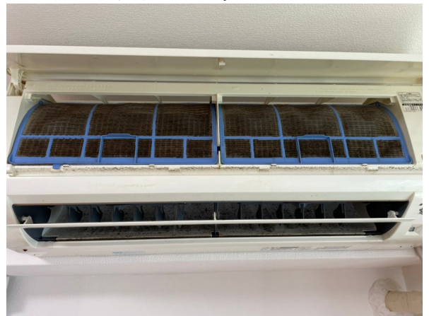
17.エアコンクリーニング
