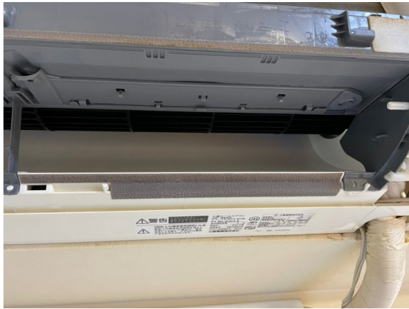
17.エアコンクリーニング
