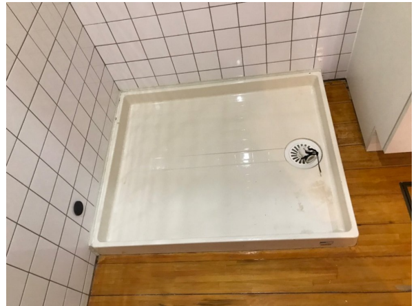
7.洗濯機防水パン
