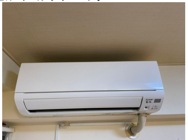
17.エアコンクリーニング
