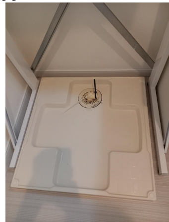
8.洗濯機防水パン
