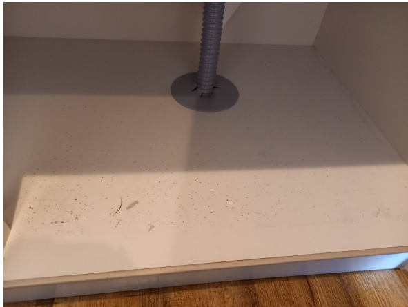
シンク下の棚板がキズと凹凸有り
