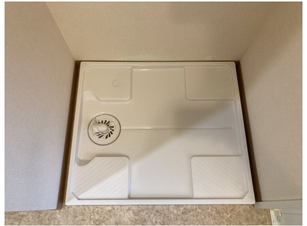
7.洗濯機防水パン
