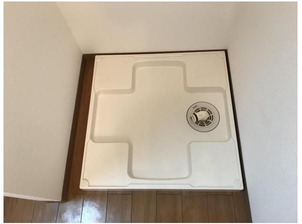
7.洗濯機防水パン
