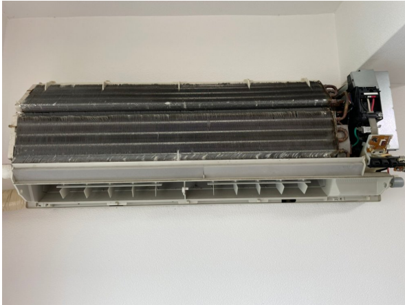
13.エアコンクリーニング
