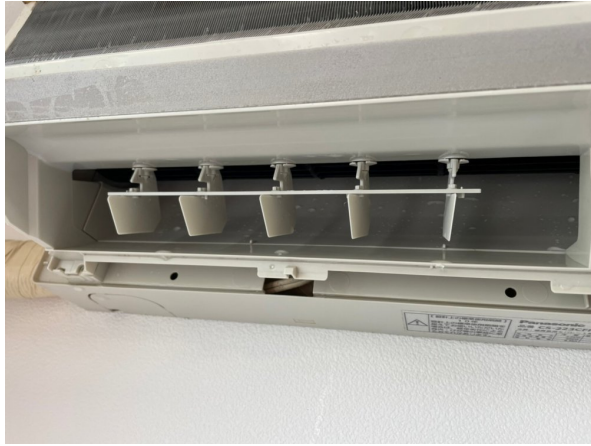
13.エアコンクリーニング
