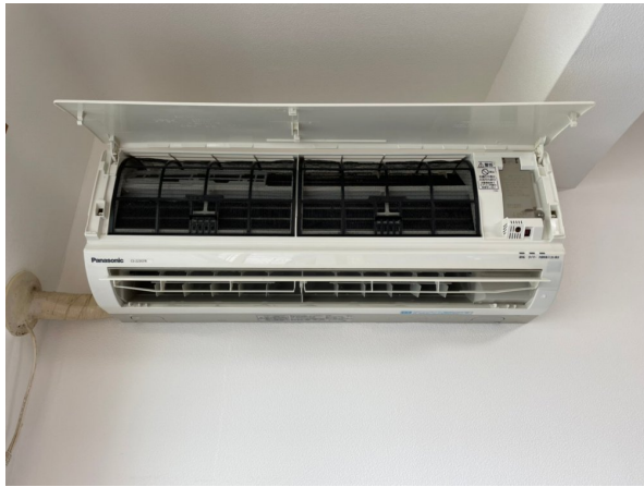
13.エアコンクリーニング
