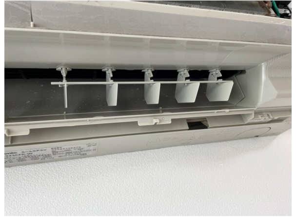
13.エアコンクリーニング
