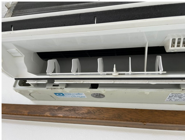
11.エアコンクリーニング
