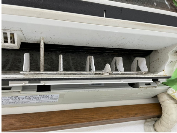
11.エアコンクリーニング
