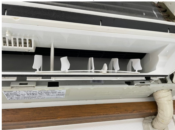
11.エアコンクリーニング
