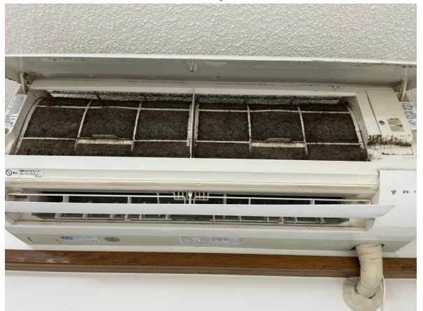
11.エアコンクリーニング
