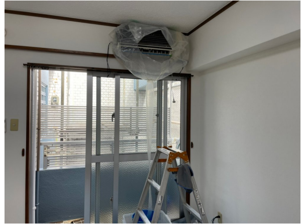
11.エアコンクリーニング
