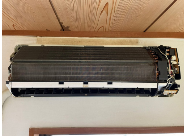
16.エアコンクリーニング
