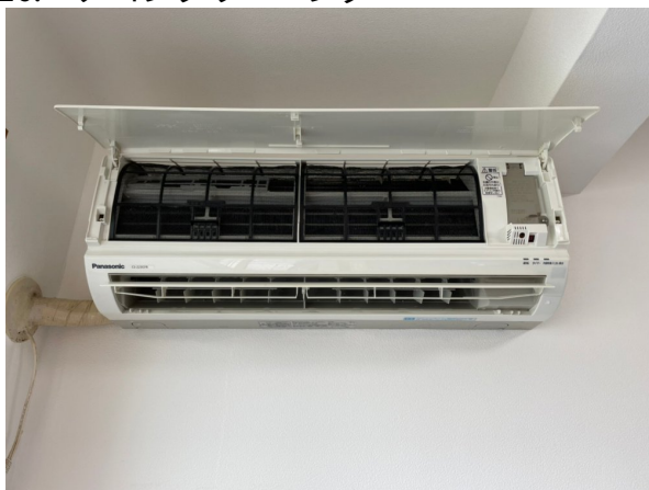
16.エアコンクリーニング
