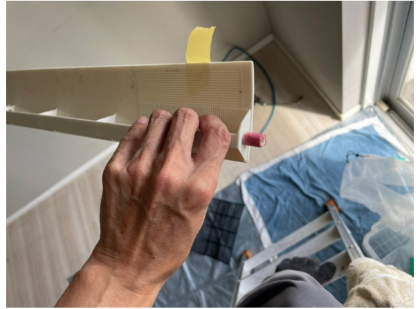
ルーバー破損
