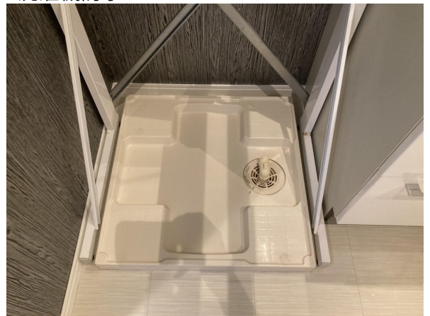
8.洗濯機防水パン
