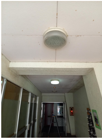
入口廊下 2ヶ所電球切れ
