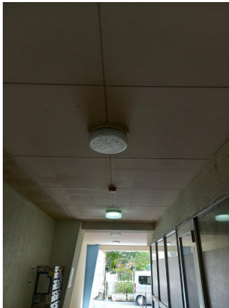
入口廊下 電球切れ
