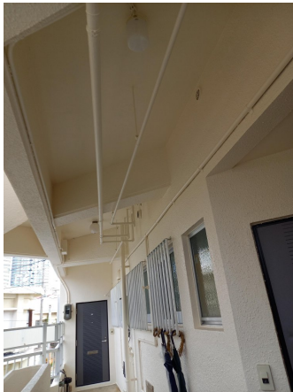
2階廊下 2ヶ所 電球切れ
