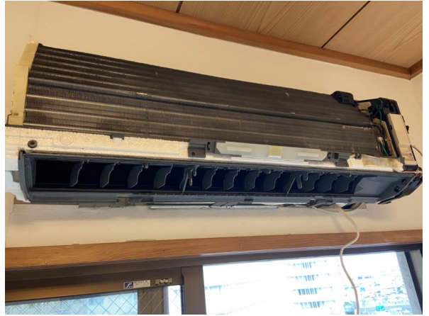
15.エアコンクリーニング
