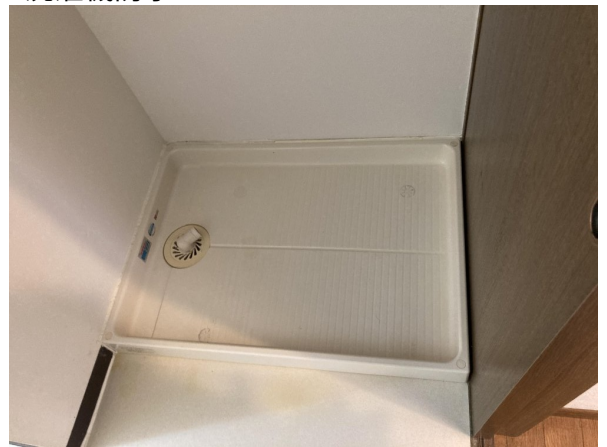
7.洗濯機防水パン
