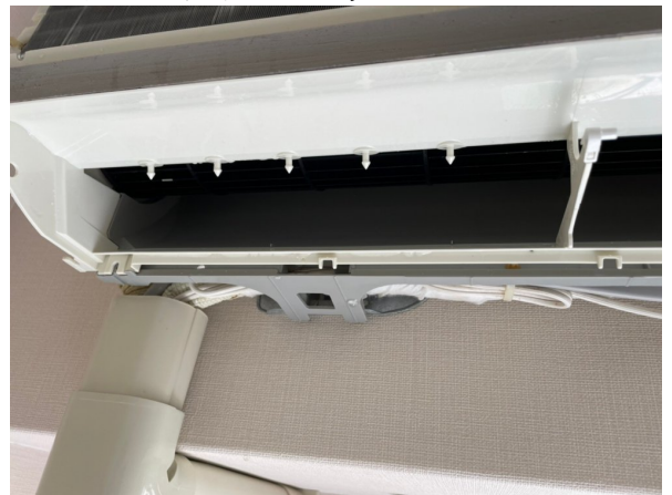
15.エアコンクリーニング
