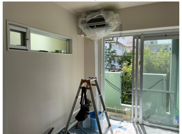
15.エアコンクリーニング
