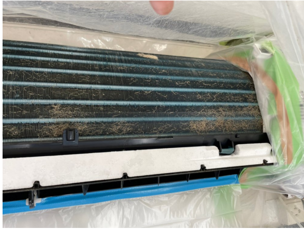
16.エアコンクリーニング
