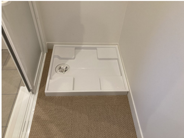
7.洗濯機防水パン
