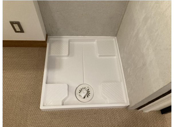
7.洗濯機防水パン
